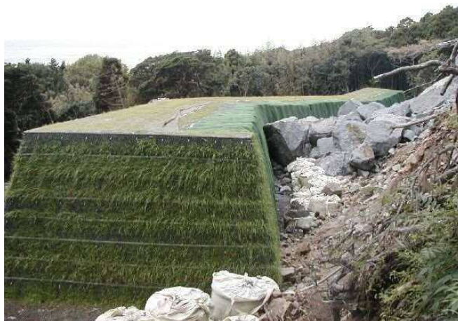
落石を受けた後のジオロックウォール
