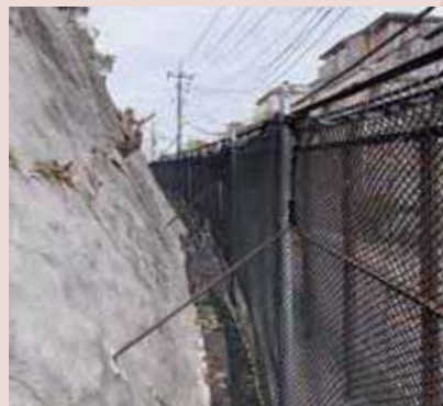
神奈川県 (支柱タイプ)
