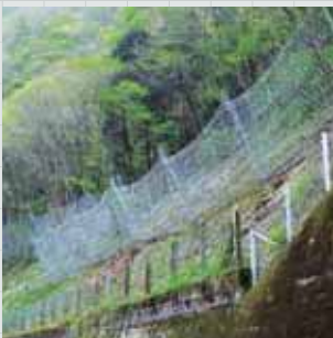
落石防護柵工 MJネット
