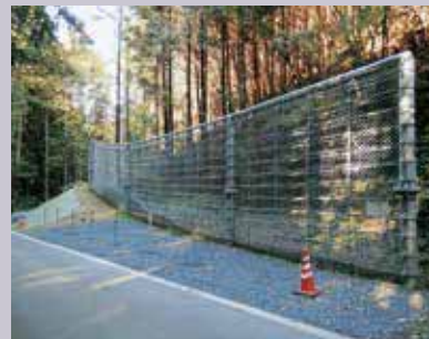
LP500 (茨城県東茨城郡城里町塩子)
