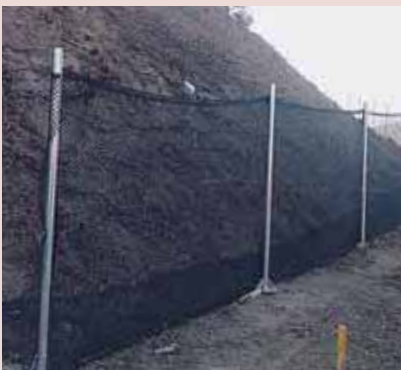
徳島県 (支柱タイプ)
