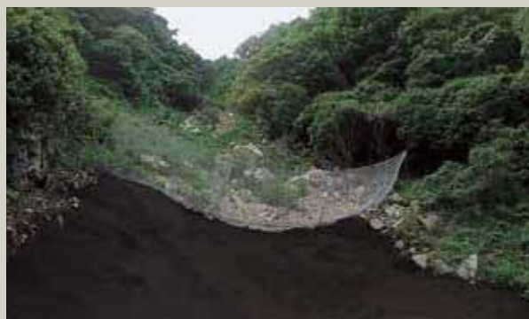
RB500 (広島県呉市)
