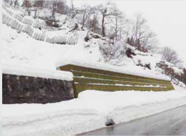
山形県最上郡真室川町(壁高4.5m)
