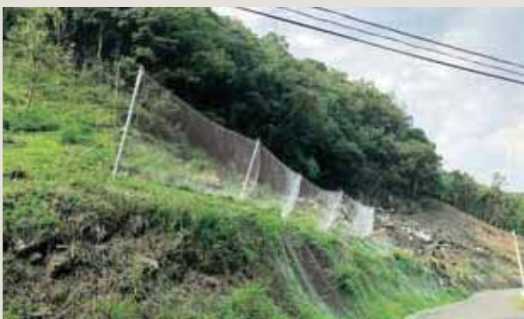
RB300 (大分県玖珠郡玖珠町古後)
