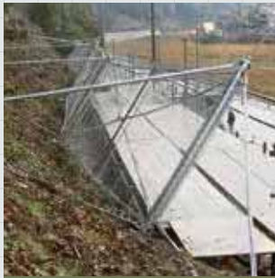
落石防護柵工 ARCフェンス
