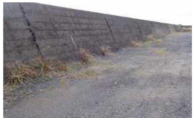
ネットバッファあり 変状なし
