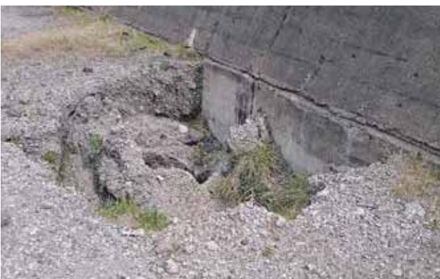
ネットバッファなし 陥没が繰り返し発生
