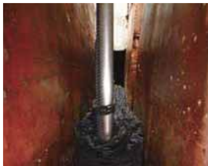
5 ネットバッファ設置状況
