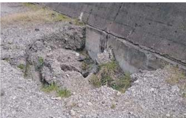
ネットパッドなし 陥没が繰り返し発生
