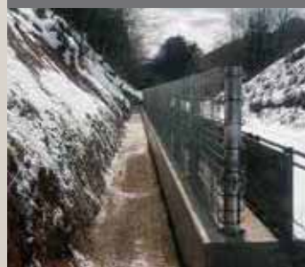
待受防護柵工 ループフェンス E タイプ
