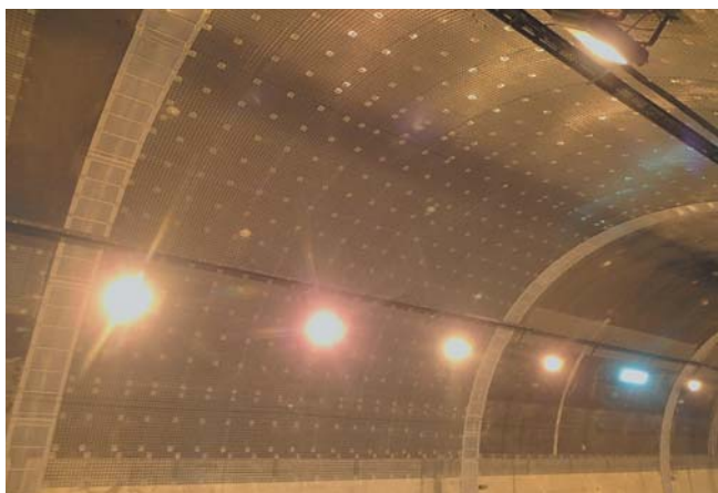
某トンネルはく落対策：不良部が多く広範囲で設置
