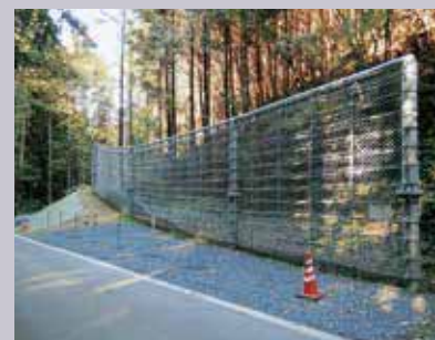
LP500 (茨城県東茨城郡城里町塩子)
