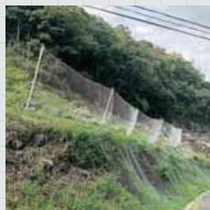
落石防護柵工 ロックバリア
