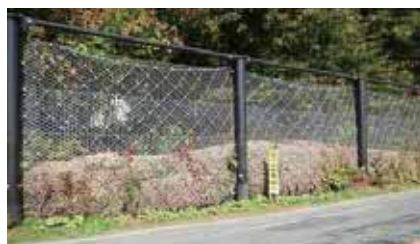
土砂捕捉状況
