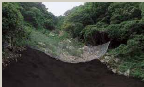
RB500 (広島県呉市)
