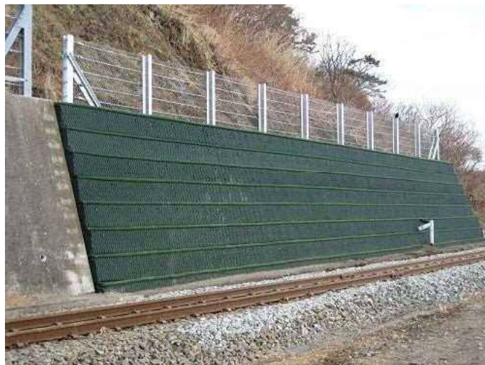
鉄道沿いに設置された防草タイプのQKウォール
