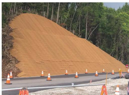
石川県穴水町
